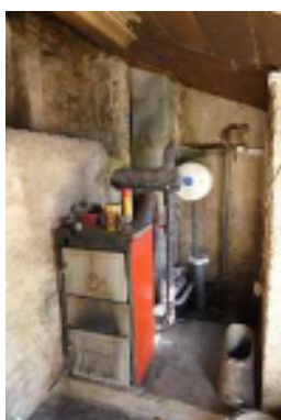
kotelná přístupná ze dvora
